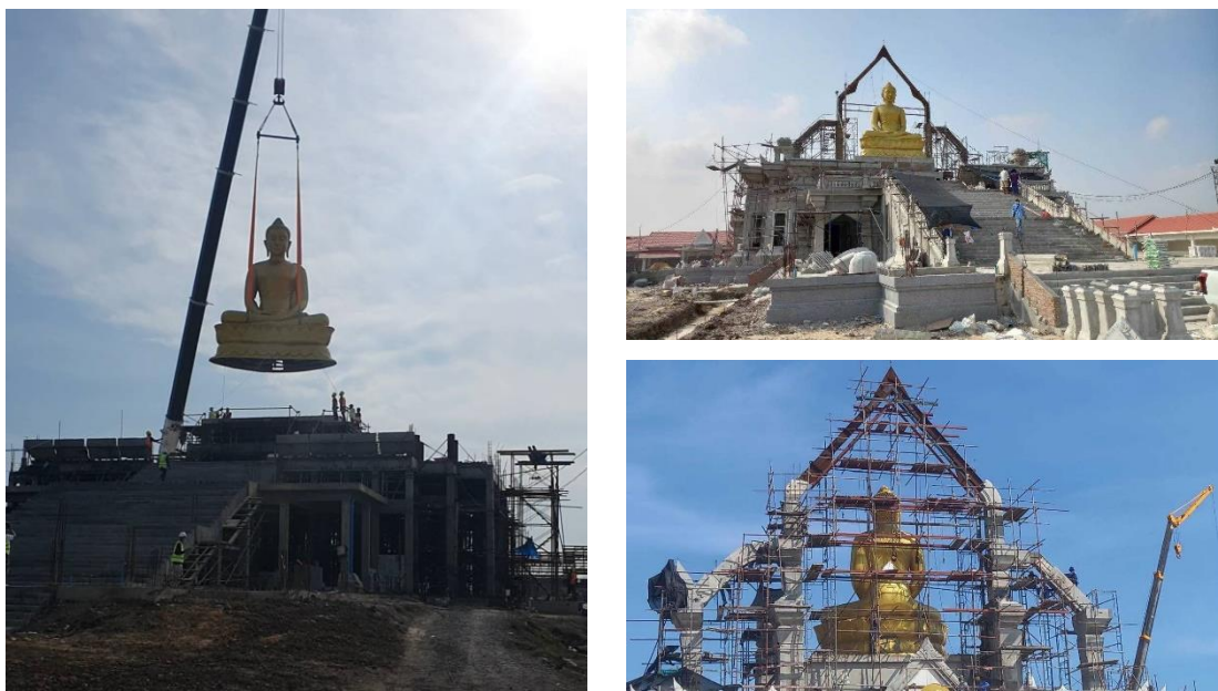
ภาพที่ 2 ตัวอย่างปัญหาการก่อสร้างซุ้มเรือนแก้วเนื่องจากอยู่บนที่สูง
