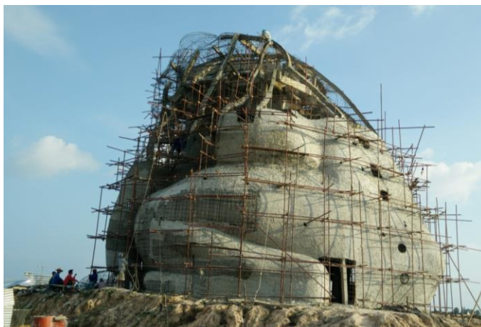
ภาพที่ 20: การก่อสร้างส่วนผนังของอาคารพิพิธภัณฑสถานควมคัก
